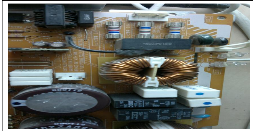
شكل (21):صورة تظهر الفيوزات
