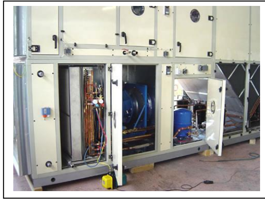
شكل (22): خدمة وحدة مناولة الهواء
