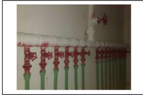
شكل (1-1): تركيب المحابس على الشبكة
